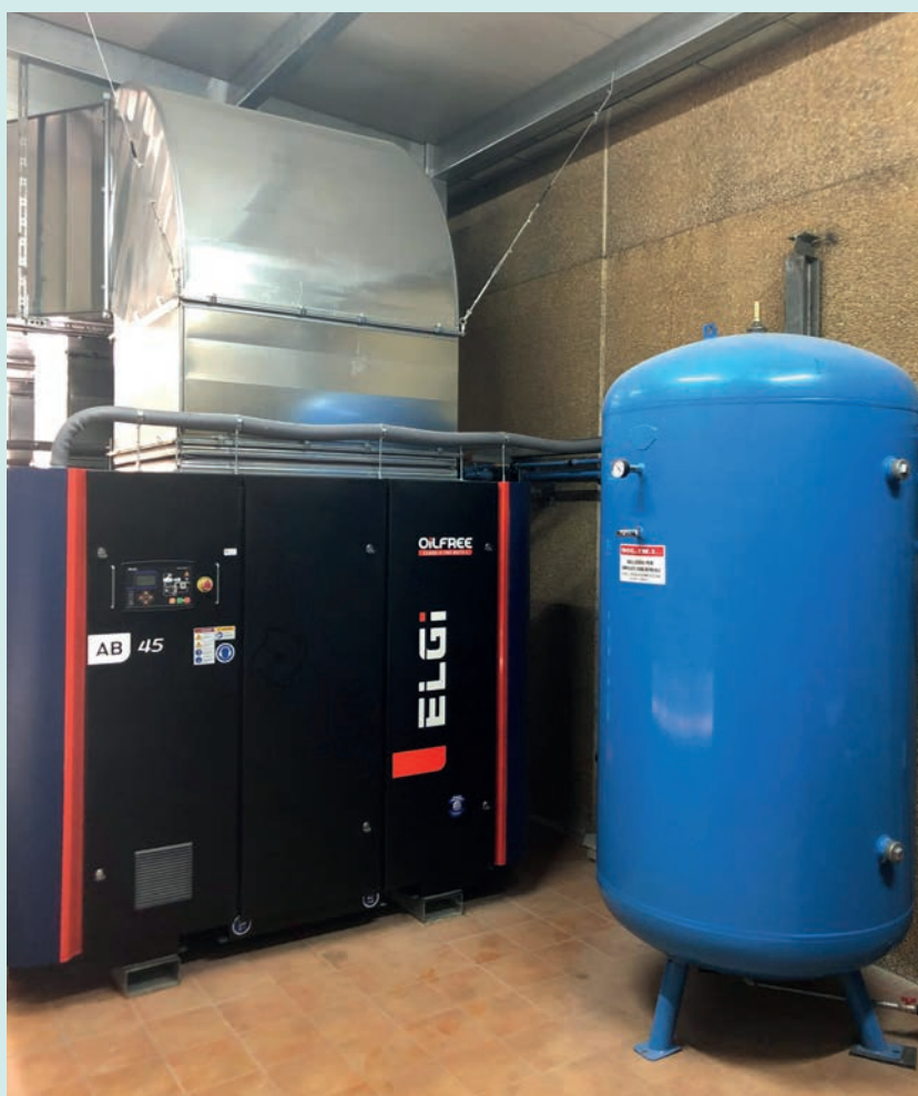
I tre compressori oil-free della serie ELGi AB sono stati installati a gennaio 2022
